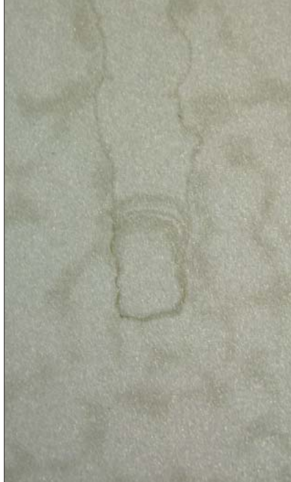
Die EP-Zwischenbeschichtungen zeigten bereits nach 30 Tagen Freibewitterung eine leichte Verfärbung. Nach 90 Tagen wurden diese deutlich heller und fleckiger.
